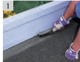
1 Remover la gravilla suelta de las membranas existentes con un cepillo metálico.
